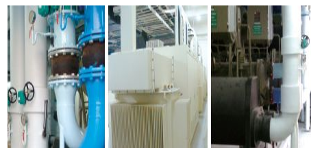
冷却・ボイラー・スクラバー
